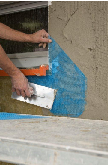
Die Qualität des Wärmedämm-Verbundsystems bestimmt sich auch an Details wie den Anschlüssen oder Fenstereinfassungen, die hier gerade ihr diagonales Armierungsgewebe erhalten. (Foto: Knauf/Duckek)
